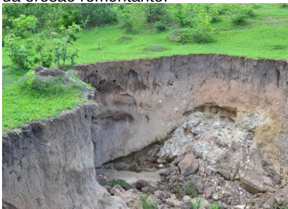
Figura 20. Talude solapado muito Instável indicando previsão de evolução da erosão remontante.
