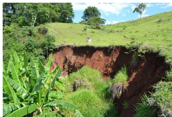
Figura 38. Taludes com solo exposto à montante da erosão
