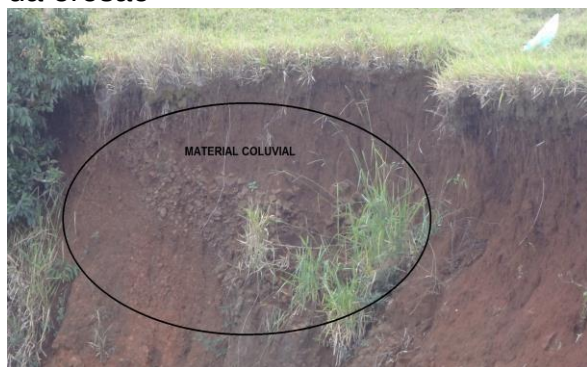
Figura 48. Material Coluvial à montante da erosão
